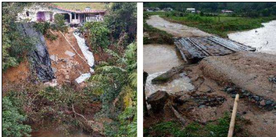
Figura 251 - Deslizamento com danos a habitação, comprometendo sua estrutura. Dano em ponte Alto Rio Fortuna.
