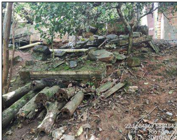
Figura 182 - Estrutura da residência que foi comprometida devido à instabilidade do terreno
