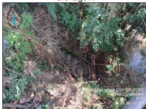
Figura 173 - Obstrução Resíduo em drenagem
