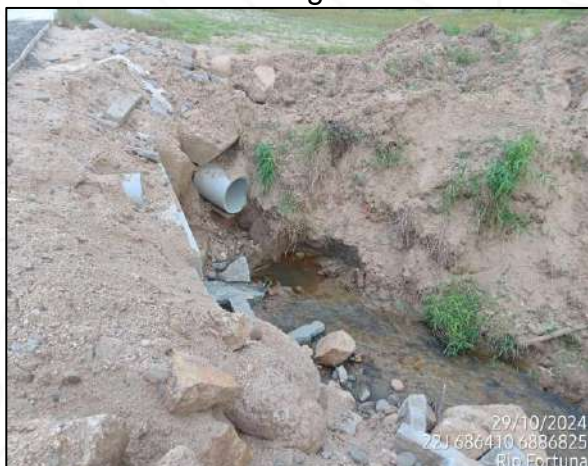
Figura 170 - Obstrução de Estruturas de Drenagens
