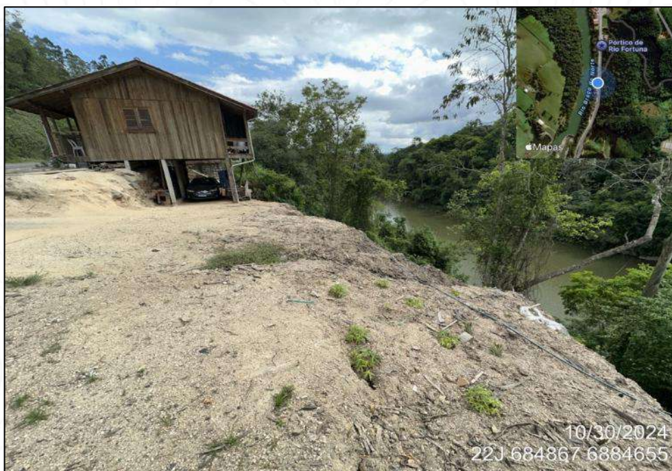
Figura 210 – Vista geral de uma residência situada na margem do rio, onde nesta área já está instalado no talude da margem do rio, processos erosivos como solapamento da margem.
