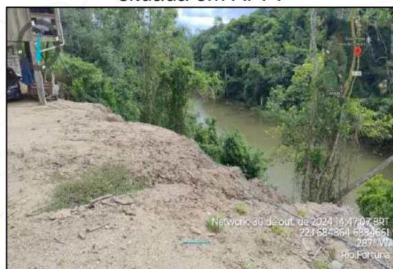
Figura 185 - Evidência de solapamento do solo muito próxima à residência situada em APP.
