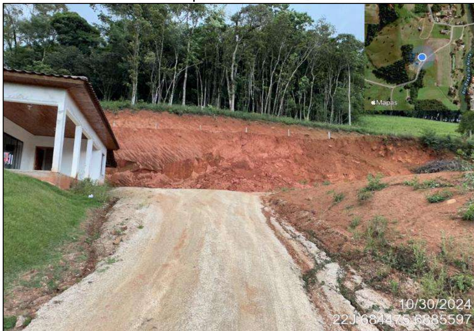
Figura 26 – Vista geral de um corte no talude composto de solo residual de diabásio, ao fundo da residência, onde destaca-se um solo com cor vermelha predominante.
