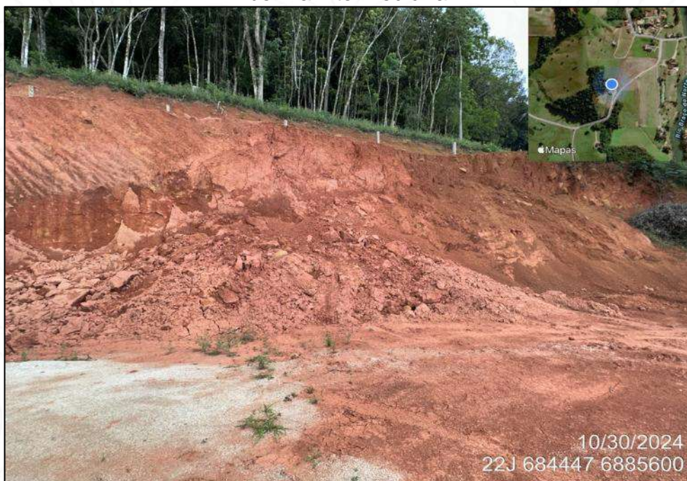
Figura 27 – Detalhe do corte em solo residual de diabásio, sediando deslizamento devido a sua alta inclinação e sem sistema de drenagem na berma intermediária.
