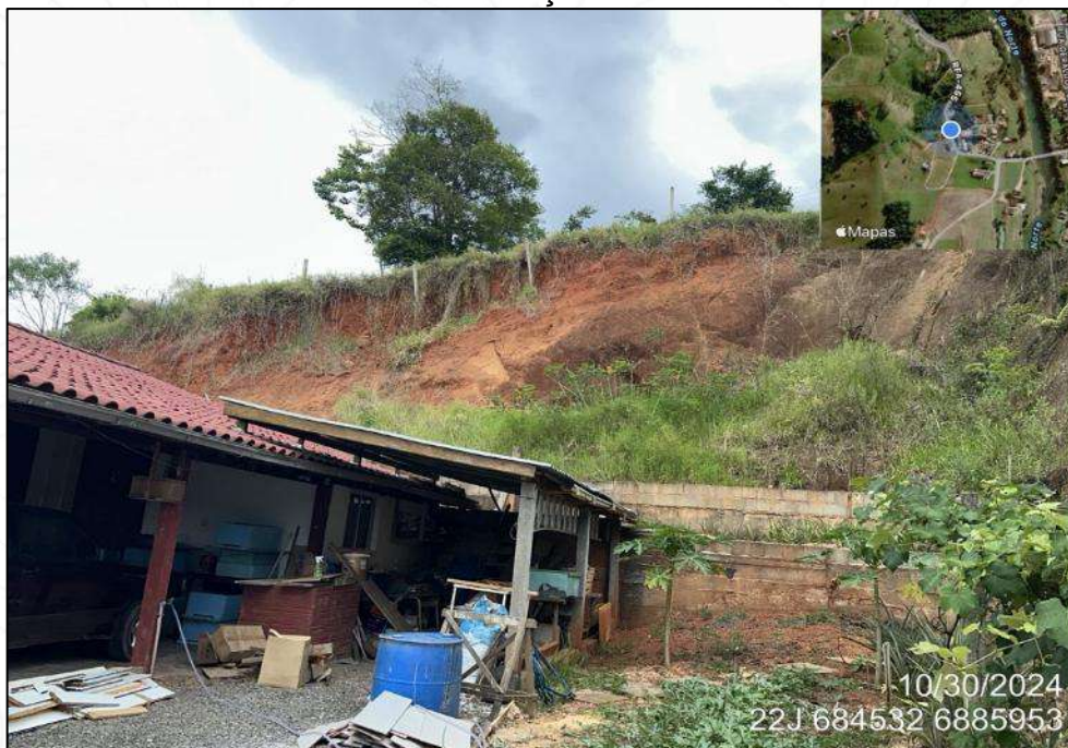
Figura 29 - Detalhe do corte em solo residual de diabásio, sediando deslizamento devido a sua alta inclinação e sem sistema na crista do talude.
