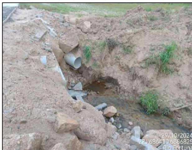
Figura 47 - Reambulação do Ponto 5 Jusante do Curso Hídrico a qual apresenta Processos Erosivos
