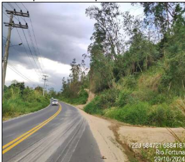
Figura 112 - Ausência de sistema de drenagem e ocorrência de erosão próximo a via pavimentada
