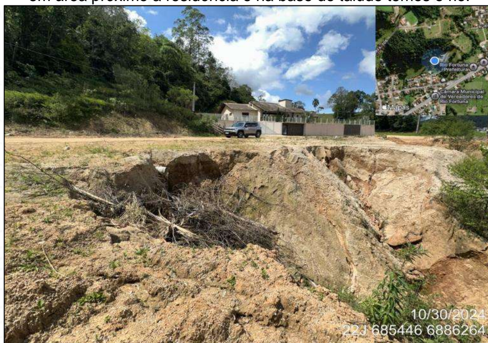
Figura 204 – Erosão na base e crista de um aterro, seguido deslizamento, em área próxima a residência e na base do talude temos o rio.
