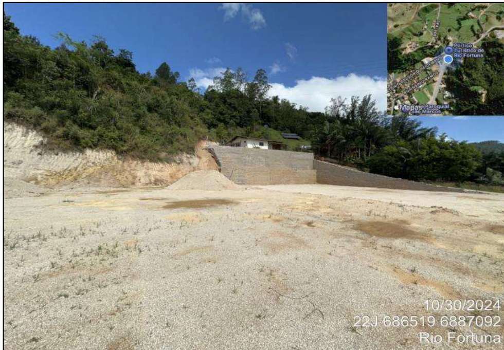
Figura 218 – Talude de corte em um lote onde houve uma intervenção estrutural caracterizada por um muro de contenção em pedra, com o objetivo de erradicar ou minimizar as possibilidades locais de instabilização.
