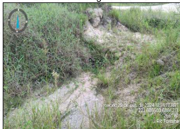
Figura 175 - Obstrução de Estruturas de Drenagens
