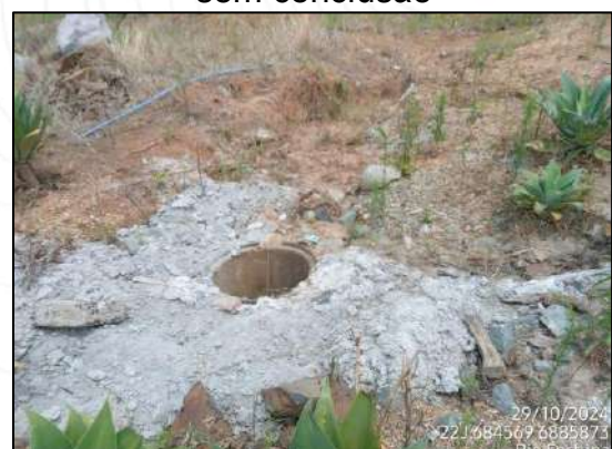
Figura 118 - Sistema de drenagem sem conclusão
