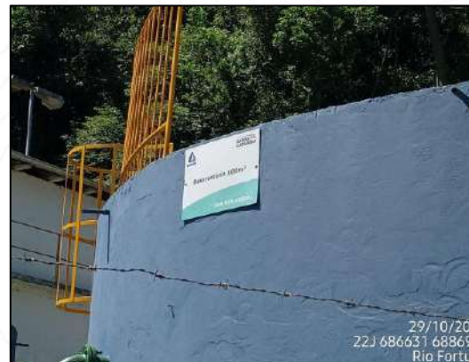
Figura 127 - Reservatório de água tratada R1 com capacidade de 100m 3
