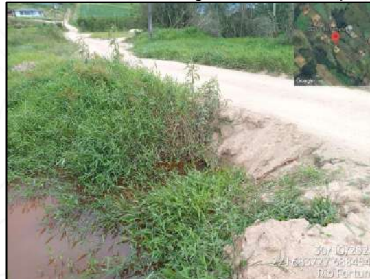
Figura 114 - Sistema de drenagem obstruído por sedimentos
