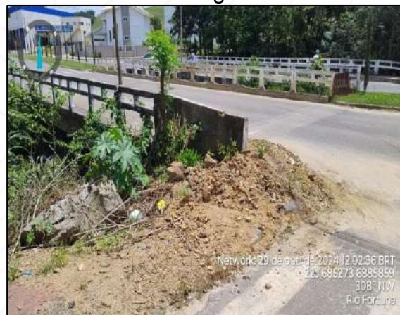
Figura 171 - Obstrução de Estruturas de Drenagens
