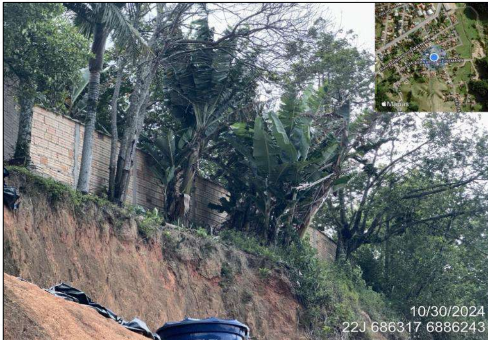
Figura 209 – Vista em detalhe deste mesmo segmento de talude, onde na crista evidencia-se bananeiras, caixa d'água, tubos de água, árvores de maior porte na crista do talude e incidência de algumas rupturas superficiais.
