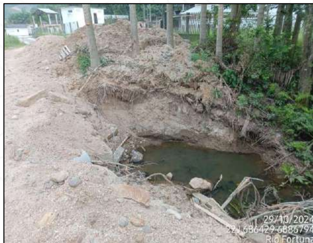
Figura 45 - Reambulação do Ponto 5 Montante do Curso Hídrico a qual apresenta Processos Erosivos
