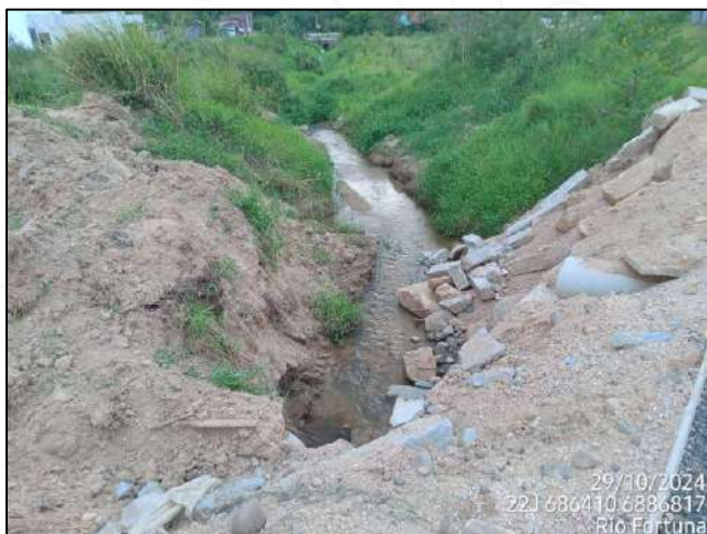
Figura 46 - Reambulação do Ponto 5 Jusante do Curso Hídrico a qual apresenta Processos Erosivos
