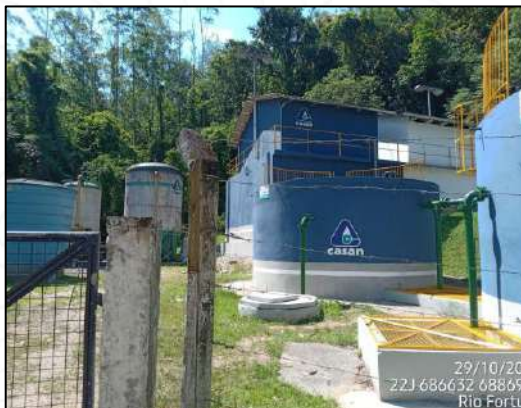
Figura 126 - Reservatório de água tratada R2 com capacidade de 50m 3
