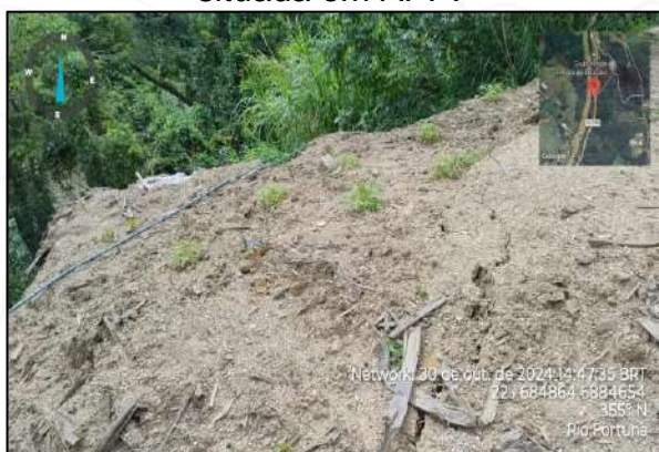
Figura 184 - Evidência de solapamento do solo muito próxima à residência situada em APP.
